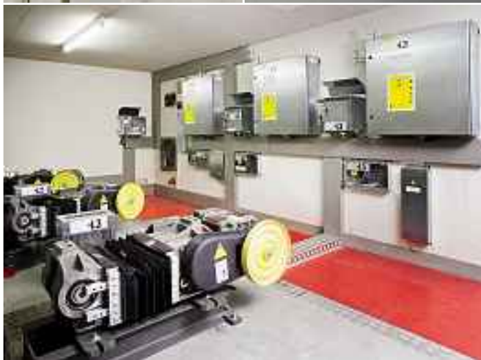
Instalación comercial triplex. El variador de frecuencia DR VAB vinculado con un cuadro de maniobra CO MX. Equipado con una máquina DR SGB 142.
