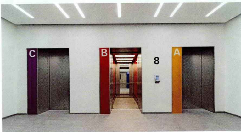
Die Aufzugsanlagen des Gebäudes wurden unter Berücksichtigung wiederverwendbarer Teile modernisiert. Während Kabinenrahmen und Führungsschienen erhalten blieben, sorgen neue Antriebe für mehr Energieeffizienz und zeitgemäße Aufzugssicherheit
