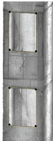
图 7. 数字测绘系统检测到的两个层门开口。
