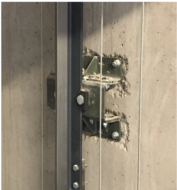
图 1. 由于井道壁超出公差，在电梯井道支架处采取纠正措施。
