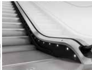
Éclairage de la plinthe avec spots
