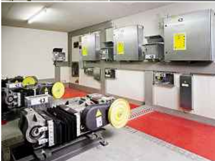
Gewerbliche Triplex-Anlage. Frequenzumrichter DR VAB, verbunden mit einer Steuerung CO MX. Antriebsmaschine: DR SGB 142.
